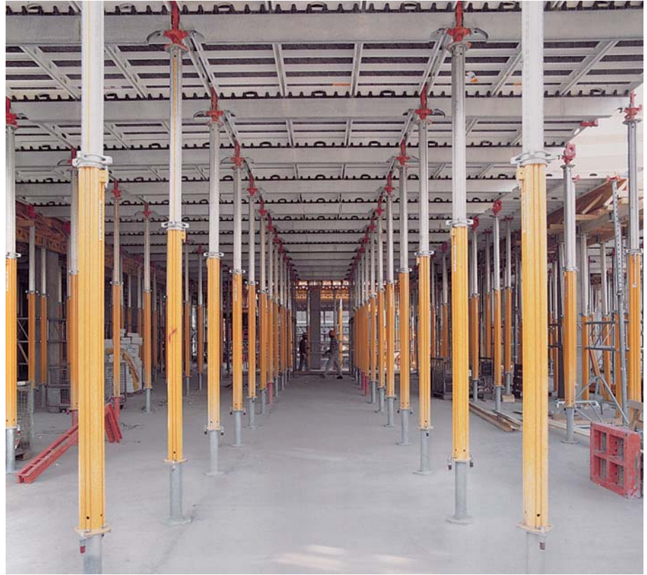
マルチプロップMP350、ベースMP50、スカイデッキを用いた建設現場 (スラブ高さは4.1m)
